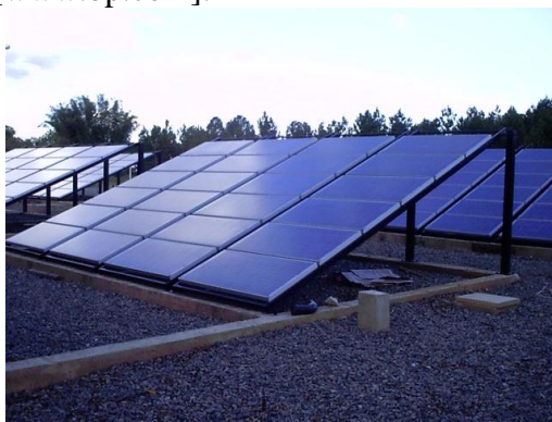
Figura 1- Visão parcial dos módulos PV instalados no Campus da UFJF.
