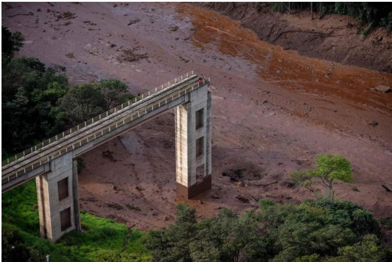
Ponte ferroviária destruída após o rompimento de barragem da Vale em Brumadinho (MG). - Douglas Magno / AFP
