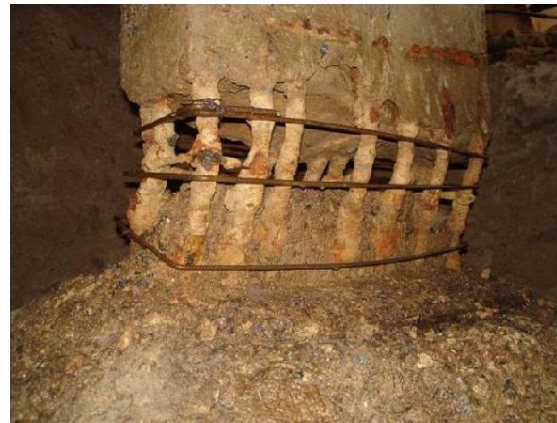
b) Ausência de concreto, oxidação e barras de aço flambadas.
