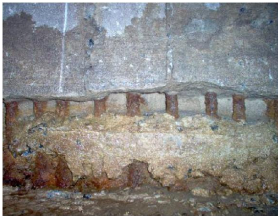
a) Ausência de concreto e oxidação em estado avançado.
