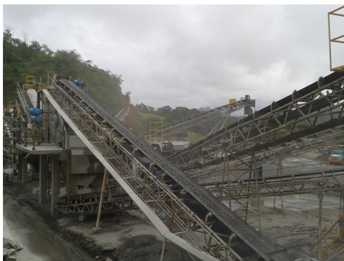
Figura 2.3. Correia transportadora da Pedra Sul.
